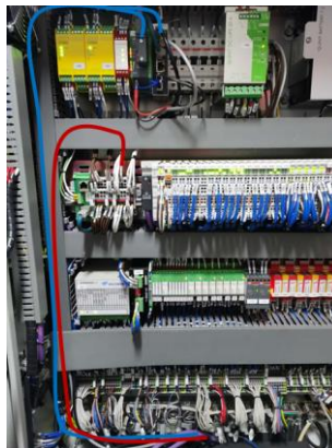
图 3-29 激光雷达线缆机舱柜内布线方式
